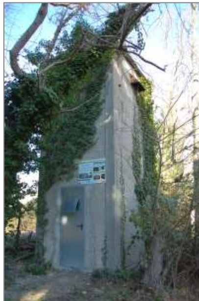
Transformateur, Mas de la Cure
